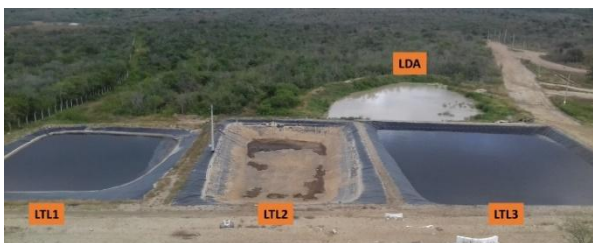
Figura 12 - Sistema de lagoas para tratamento do lixiviado gerado no ASCG
